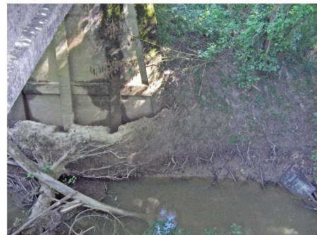
Erosion importante autour des piles du pont près de Larrigade
